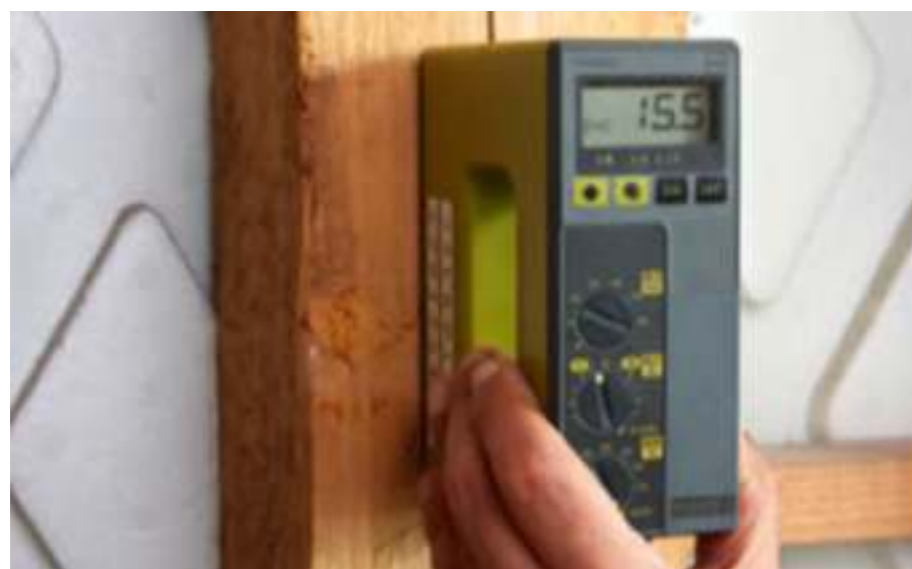
玄関脇の柱の含水率は15.5%
