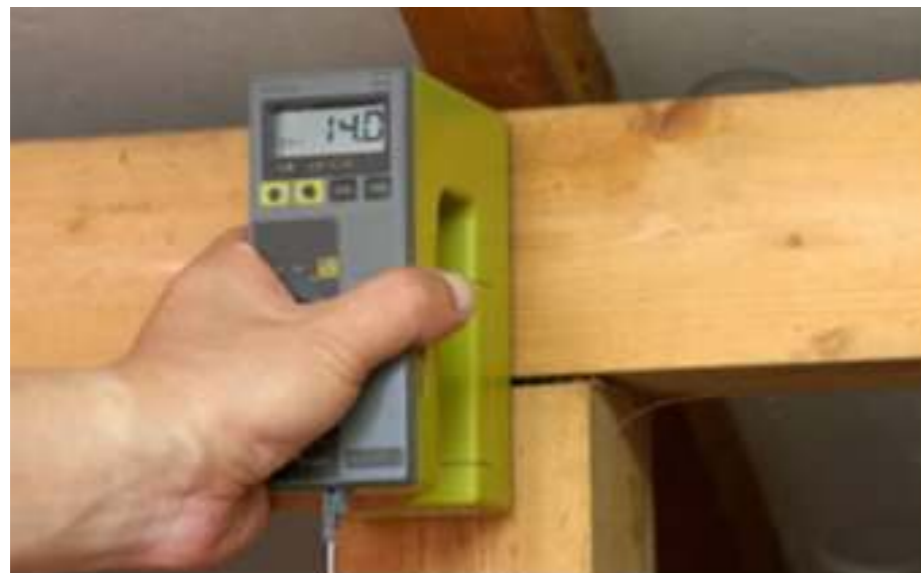
屋根裏の柱の含水率は14.0%
